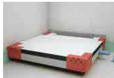
3. Sprchovou desku otočit zpět a nalepit na očištěný povrch podkladu stavebním lepidlem (popř. nízkoexpandzní PUR pěnou), vynivelovat a napojit odpadní potrubí
