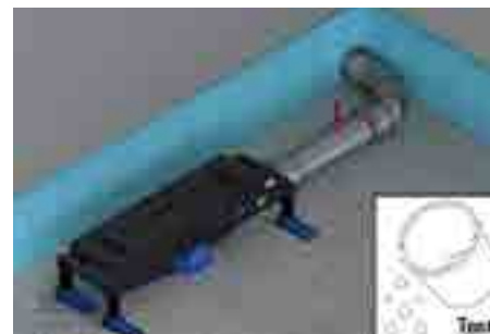
3. Napojit odtok na ležaté potrubí v jednom ze tří možných směrů odpadu a vyzkoušet těsnost
